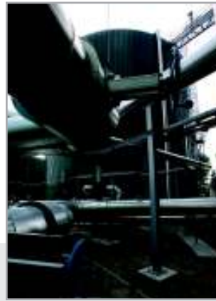
Leitungen zum Transport von Substrat, Wärme und Gas
