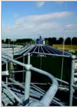
Die 3 Fermenter sind das Herzstück der Anlage
