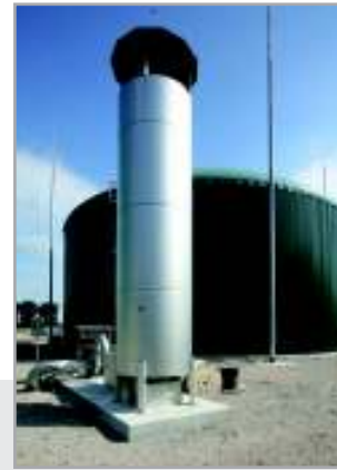
Gasfackel und Gasspeicher für einen hohen Sicherheitsstandard
